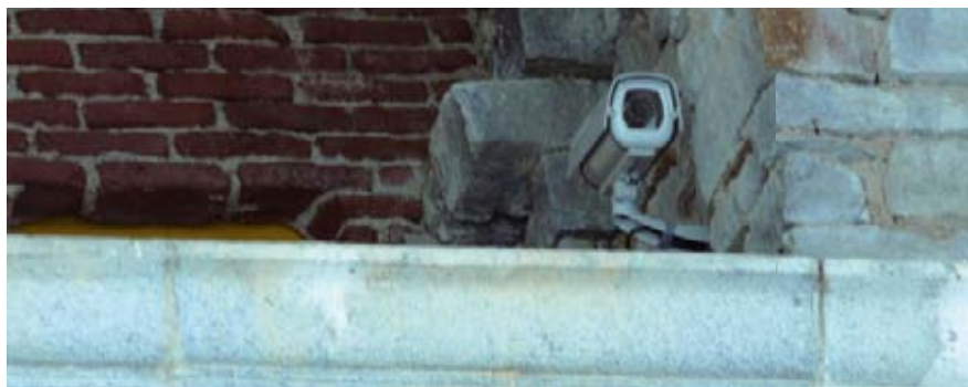
Due telecamere in custodia sono state installate a 20 metri di altezza per proteggere l'ingresso della basilica principale in piena discrezione
