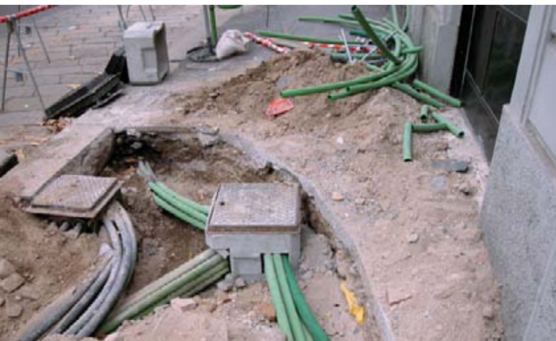
I roditori possono intaccare i cavi, soprattutto nelle installazioni sotterranee (Courtesy: kk89)
